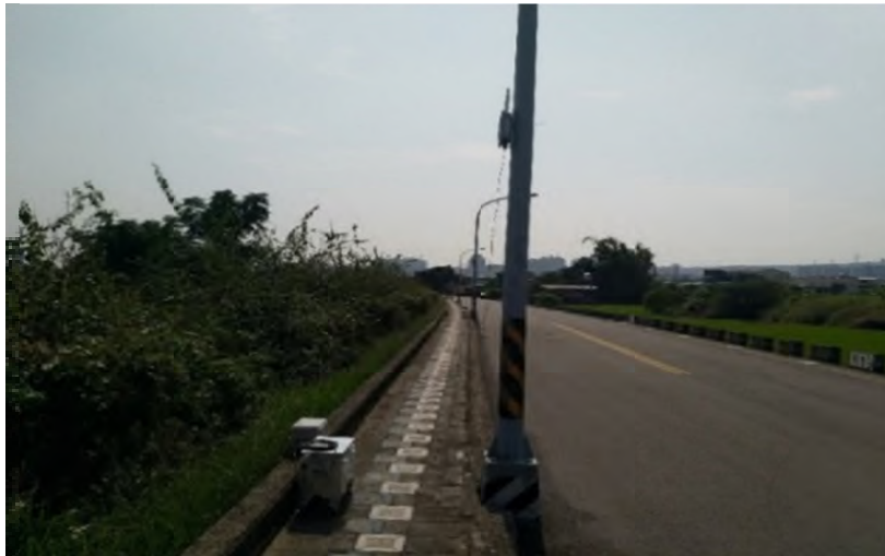
圖 3-6 設備使用電池組（圖中機箱內）供電
