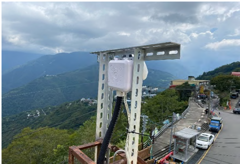
圖 3-12 自動化即時影像觀測設備
