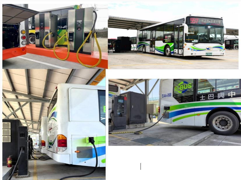
圖5-7 電動大客車充電樁
