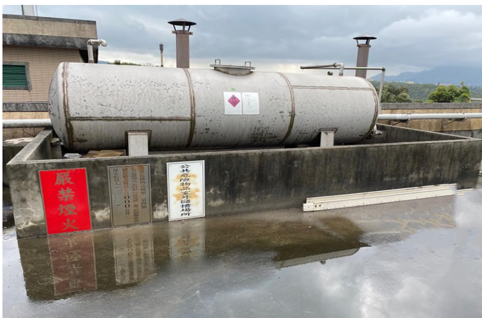
柴油地上儲槽及防污設施設置情形
