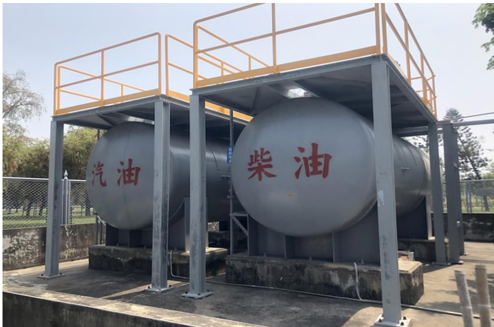
汽、柴油地上儲槽及防污設施設置情形
