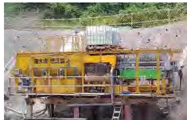
污水處理設備
