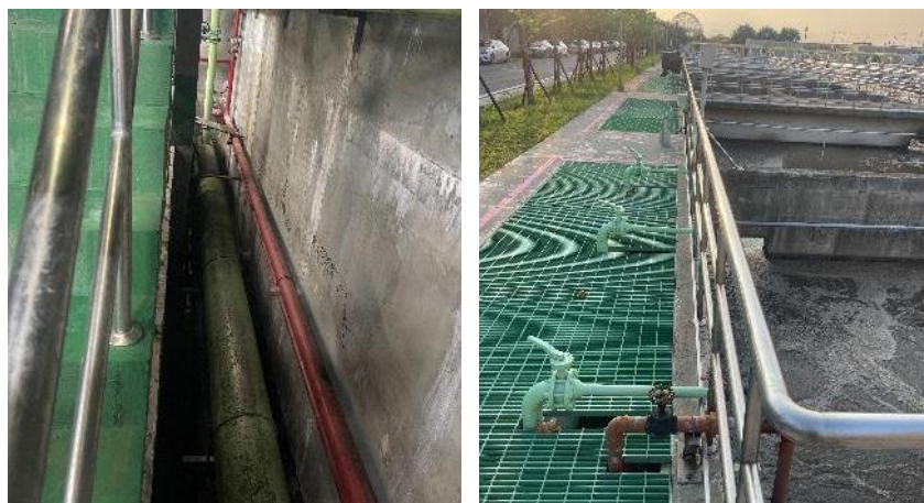
圖 28 曝氣池空氣主管與各池空氣支管
