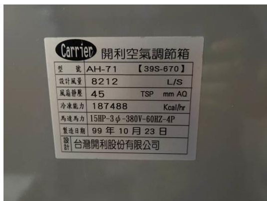
空調設備現況照片-12(7F AHU-71)
