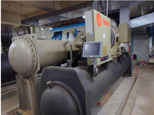
空調設備現況照片-3(98 年既設 420RT 離心式冰水主機)
