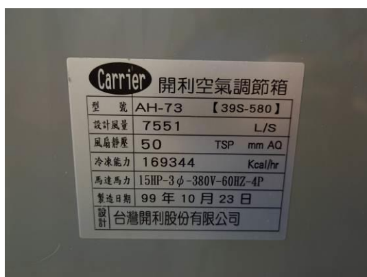
空調設備現況照片-14(7F AHU-73)
