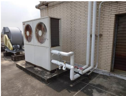
空調設備現況照片-5(10F 氣冷冰水機)
