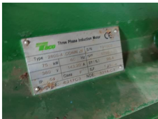
空調設備現況照片-10(CWP-1~3 75kW)
