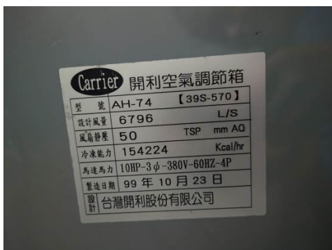
空調設備現況照片-15(7F AHU-74)
