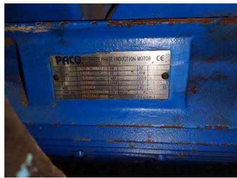
空調設備現況照片-8(CHP-4 15kW)
