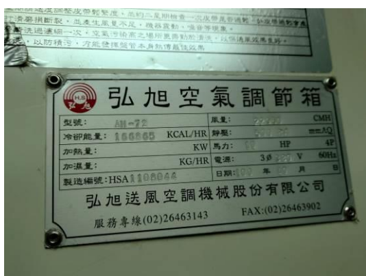
空調設備現況照片-13(7F AHU-72)
