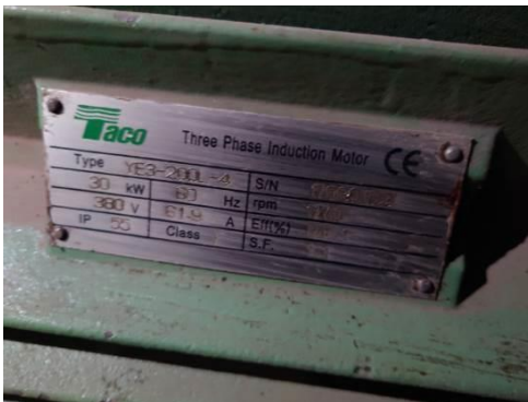
空調設備現況照片-7(CHP-1~3 30kW)
