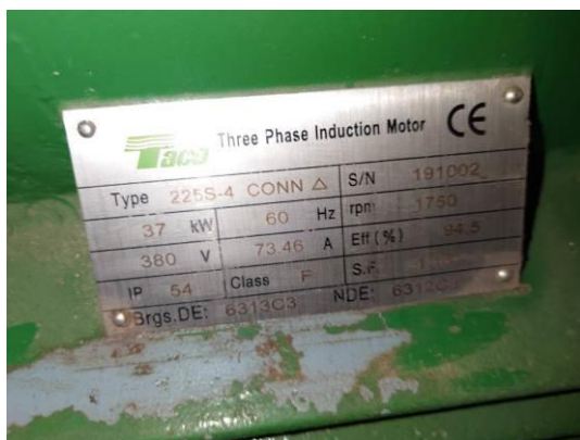
空調設備現況照片-9(ZP-1~6 37kW)
