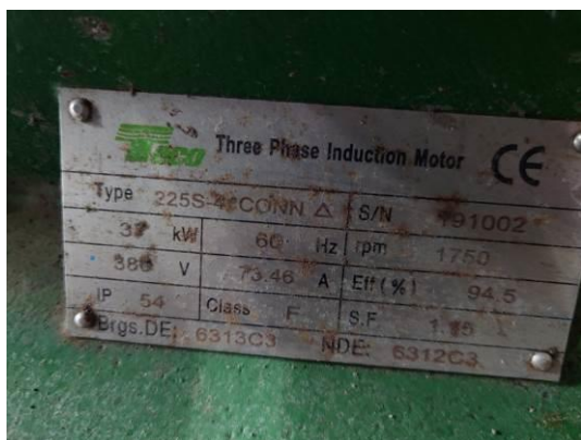
空調設備現況照片-11(CWP-4 37kW)
