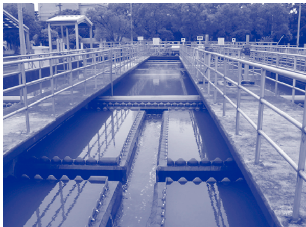
事業目前大致均已設置廢水處理設施
