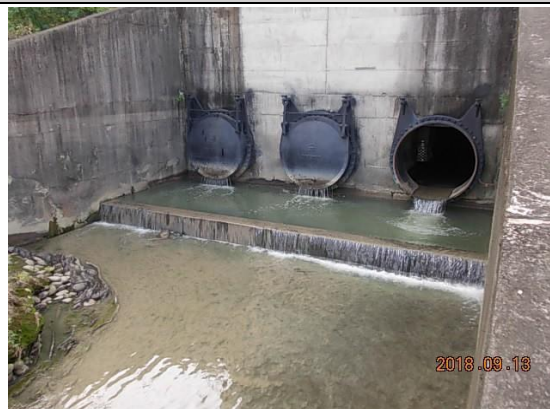
大橋區外排水〈23°02'04.0"N 120°13'24.3"E〉
