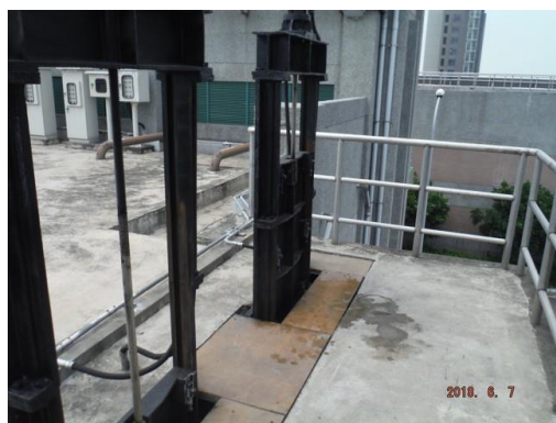
污水處理業_2-製程_1 〈臺中市后里區后科路三段 2 號〉
