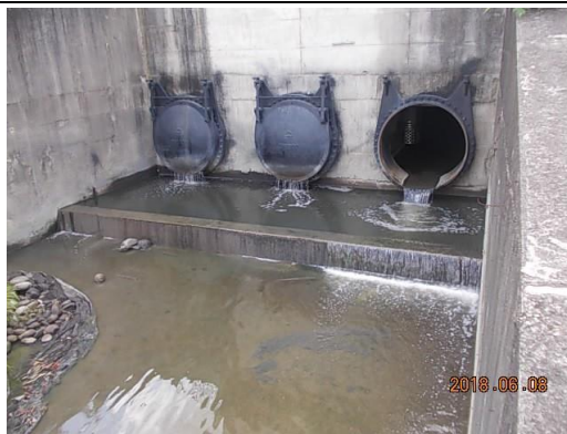
大橋區外排水 <23°02'04.0"N 120°13'24.3"E >
