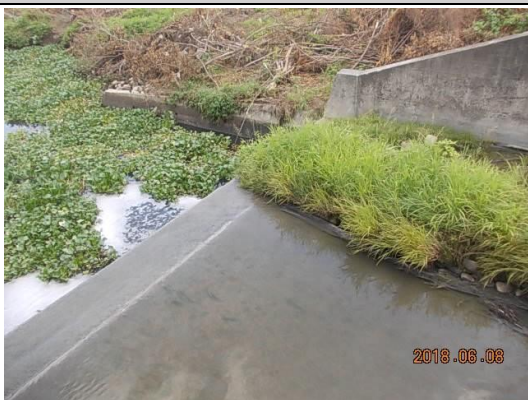
大橋區外排水 <23°02'04.0"N 120°13'24.3"E >
