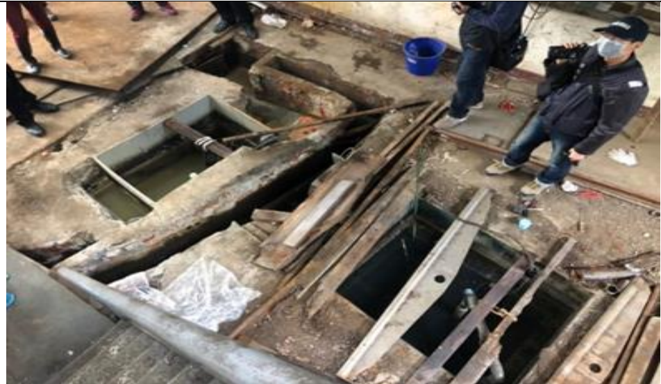
污泥儲存區下方查獲業者暗藏繞流排放廢水
