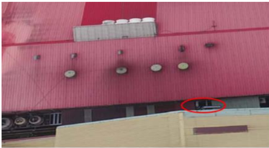
廠房側邊第 4 處繞流排放管道
