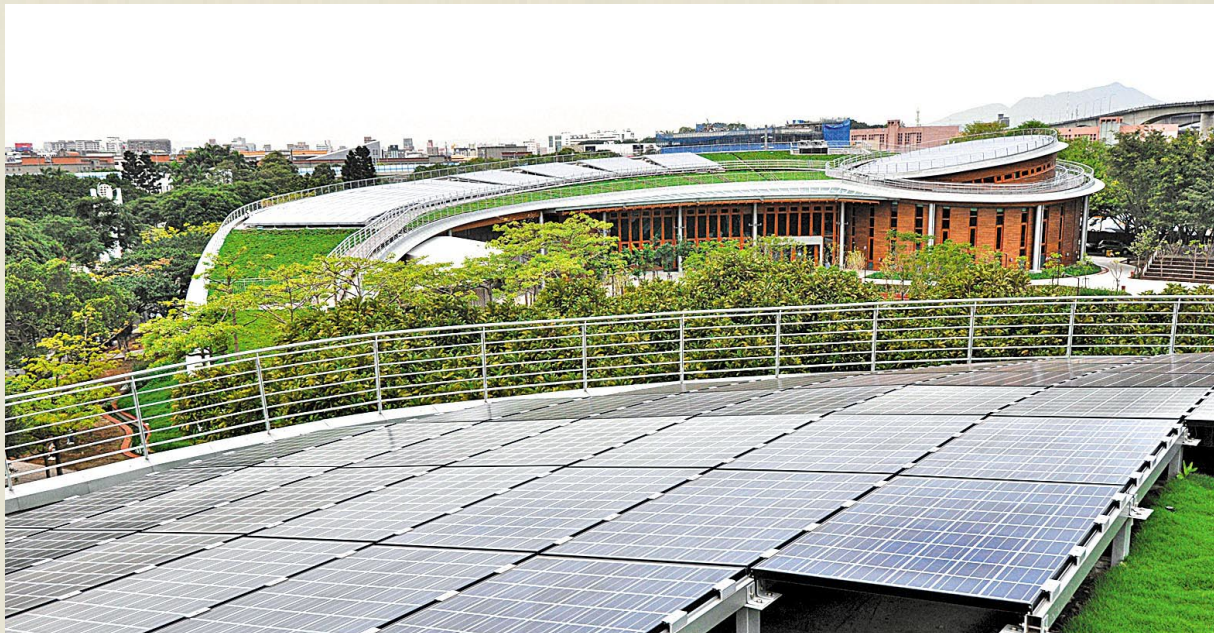
新生公園區內，未來館及夢想館的屋頂上都設置太陽能板，產生的電力將提供館內使用，符合節能減碳的理念。
