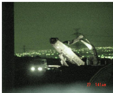
棄土場內夜間非法堆置、掩埋
