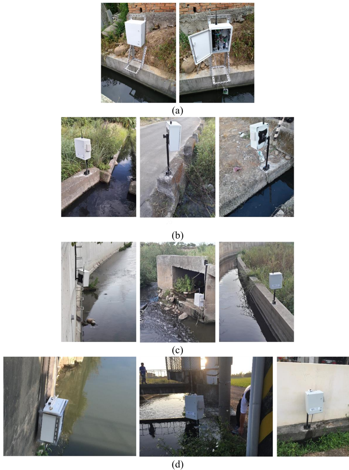
圖 3-29、(a)小型化水質監測系統原型機內裝與架設；(b)桃園市蘆竹區徐厝排水架設情況；(c)桃園市蘆竹區蘆竹排水架設情況；(d)台中市大里區大里溪架設情況。
