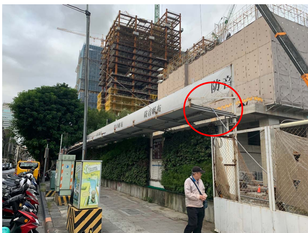
圖 3.2-6 常見錯誤的隔音毯(防音帆布)設置有空隙
