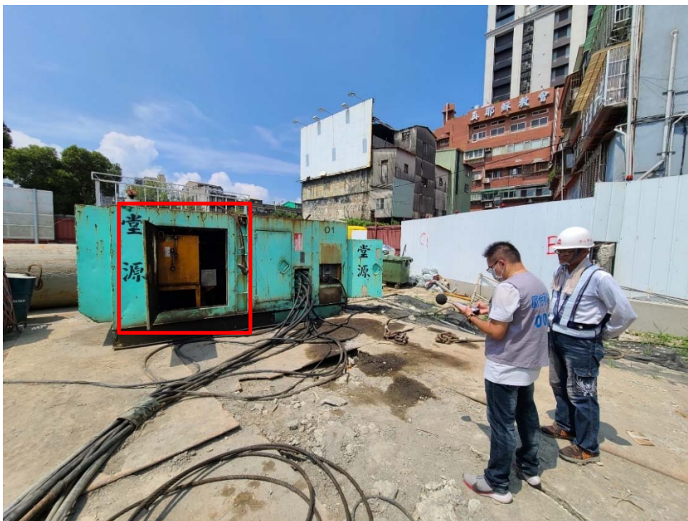
圖 3.2-7 常見錯誤的操作行為(發電機艙門未閉合)
