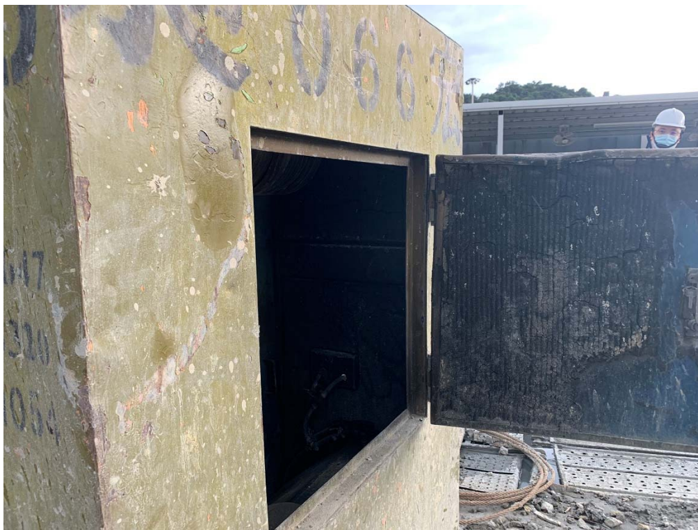
圖 3.2-9 常見錯誤的行為(設備未落實保養)
