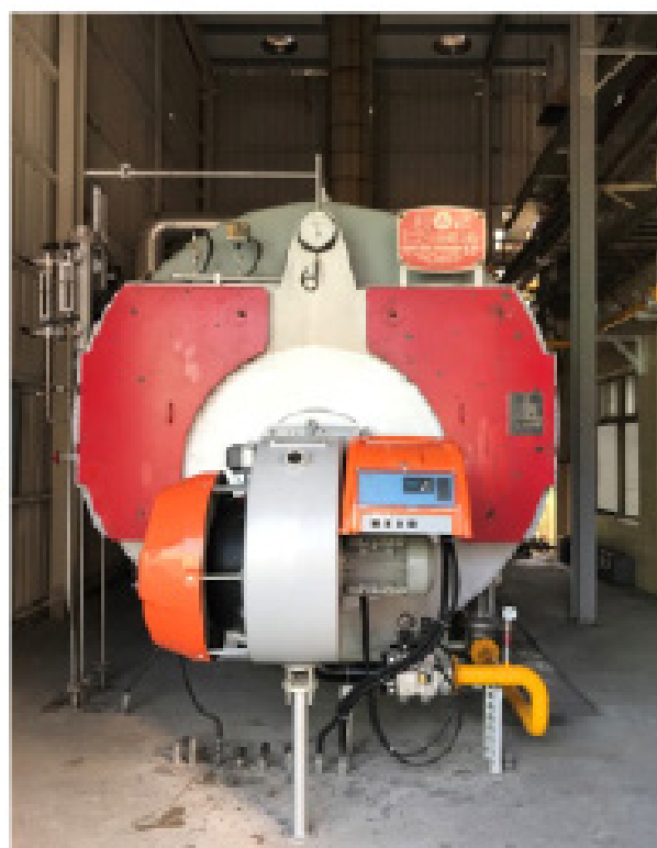
改善後燃氣鍋爐
