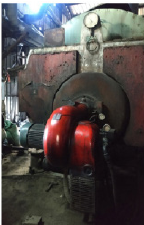
改善前燃油鍋爐
