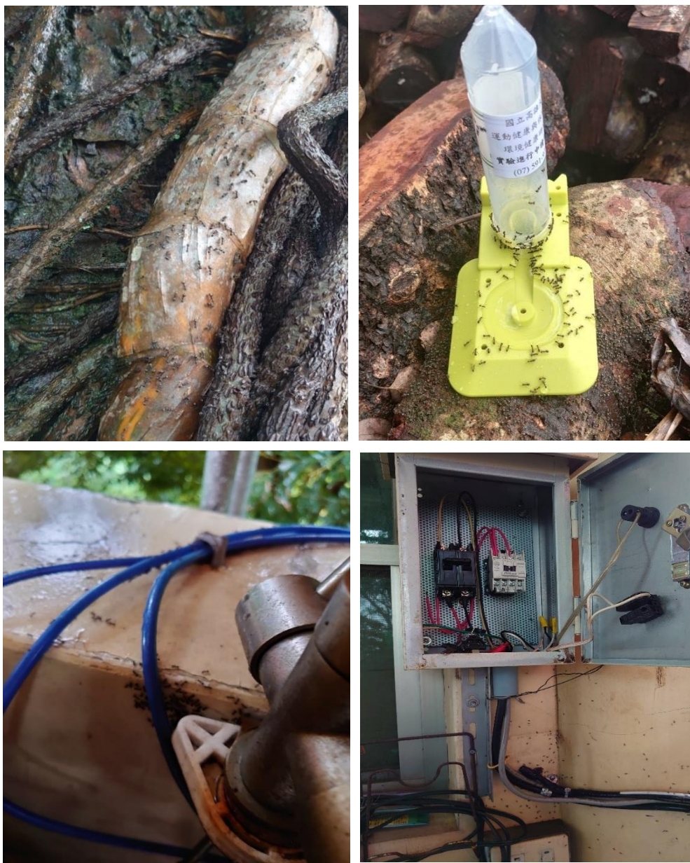
圖 1. 實地勘察疣胸琉璃蟻侵害情形
