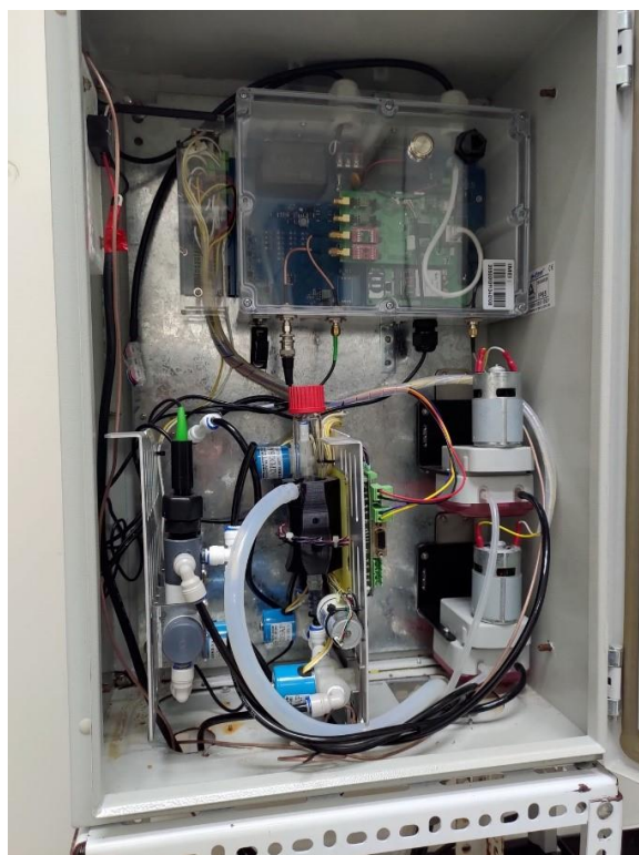
圖 5 整合濁度感測模組之固定式水質感測器照片
