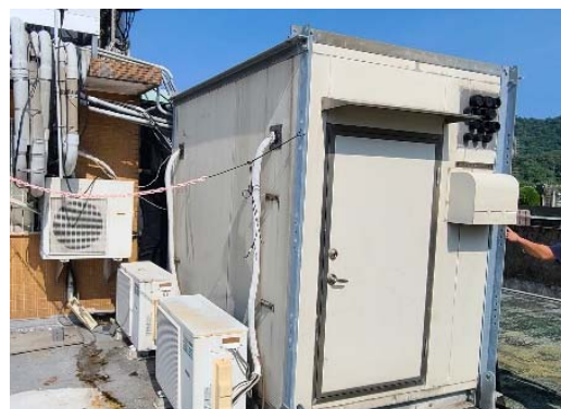
頂樓基地台機房 1
