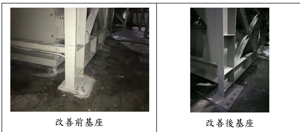
圖 4.5-4 甲處廠改善後振動源機台設備
