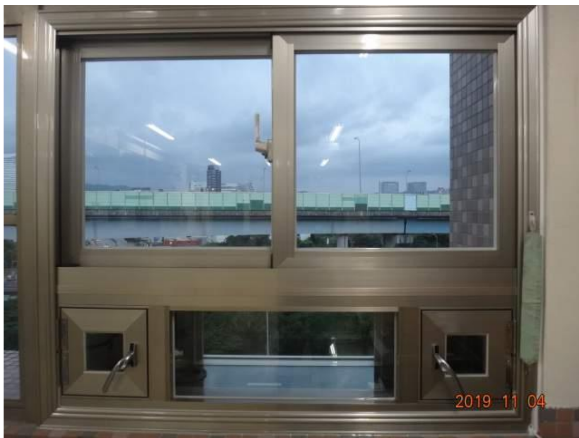
圖 4.3-6 臺北市立南湖高中物理實驗室之自然通風隔音窗 設置完成照片
