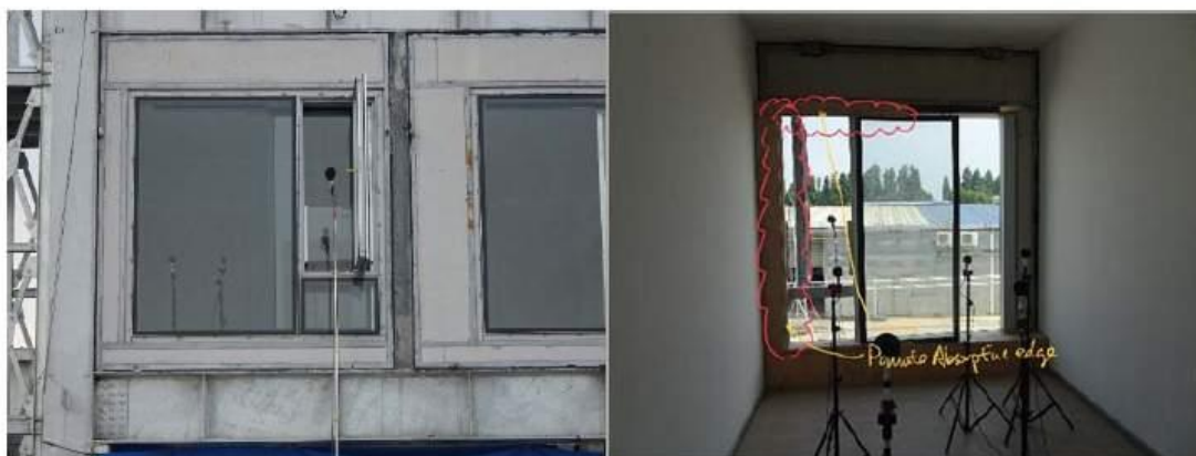
圖 4.1-25 麥克風（左：室外；右：室內）和吸音材料的安裝位置 [18]
