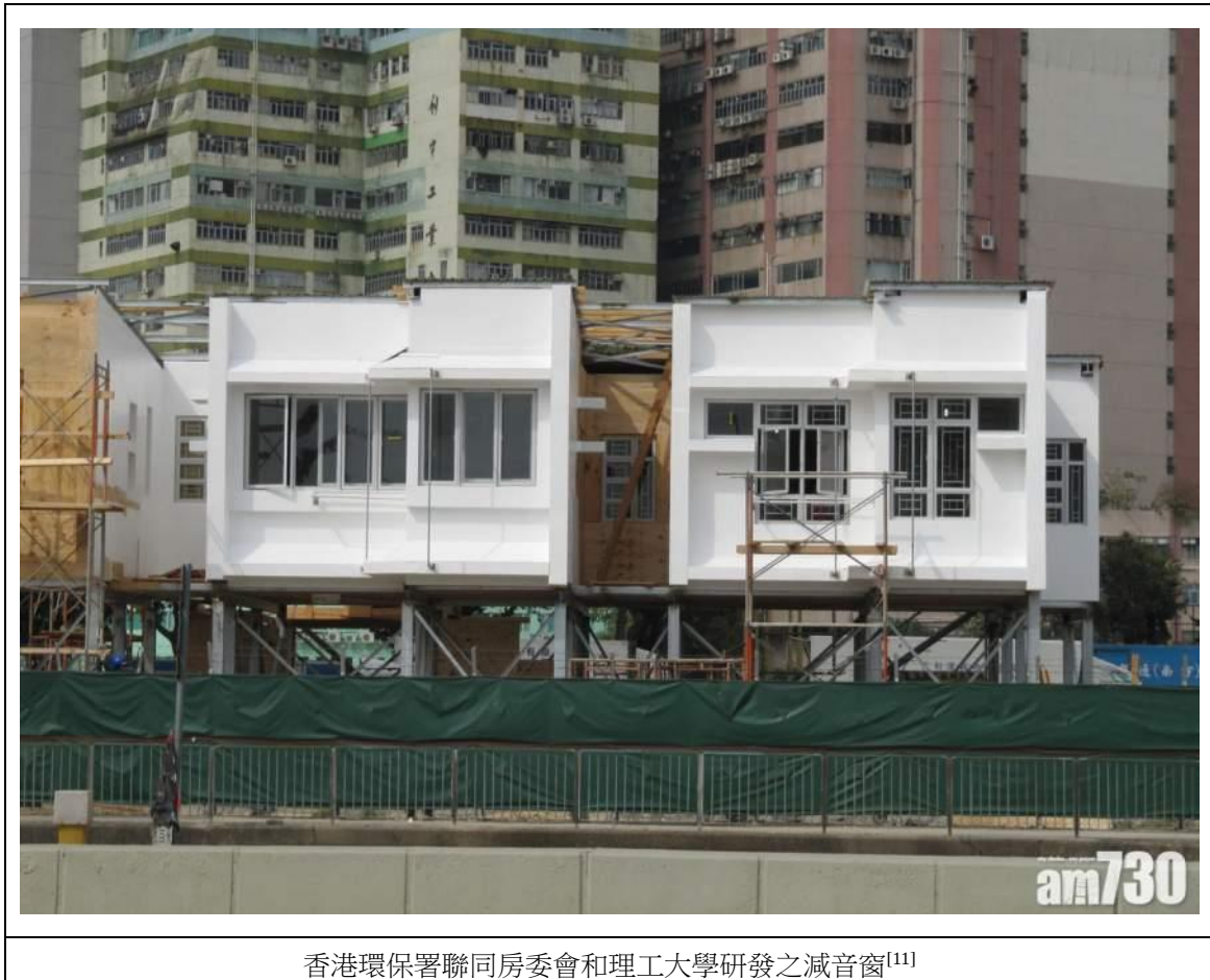
圖 4.1-12 香港於交通繁忙路段旁安裝減音窗做實地測試應用
