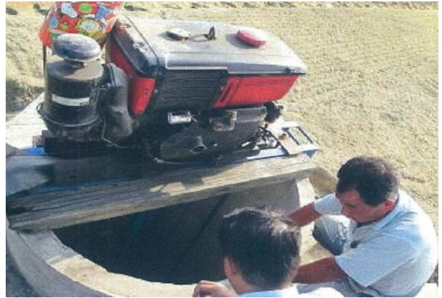
► 靠中科園區的濁水溪下游供灌溉用取水口
