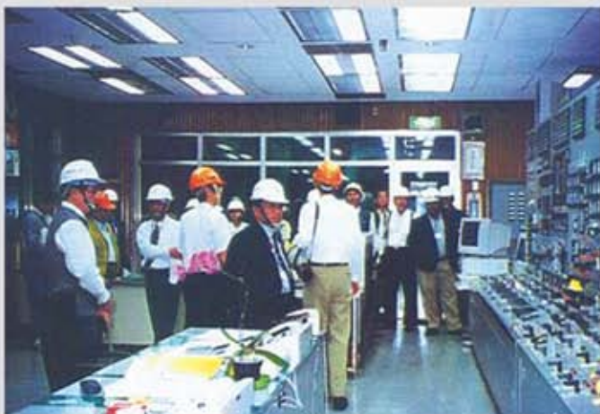
參訪林口發電廠中央控制室 (89 年)
