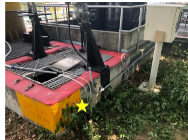
新竹科學園區污水廠二、三期入水口
