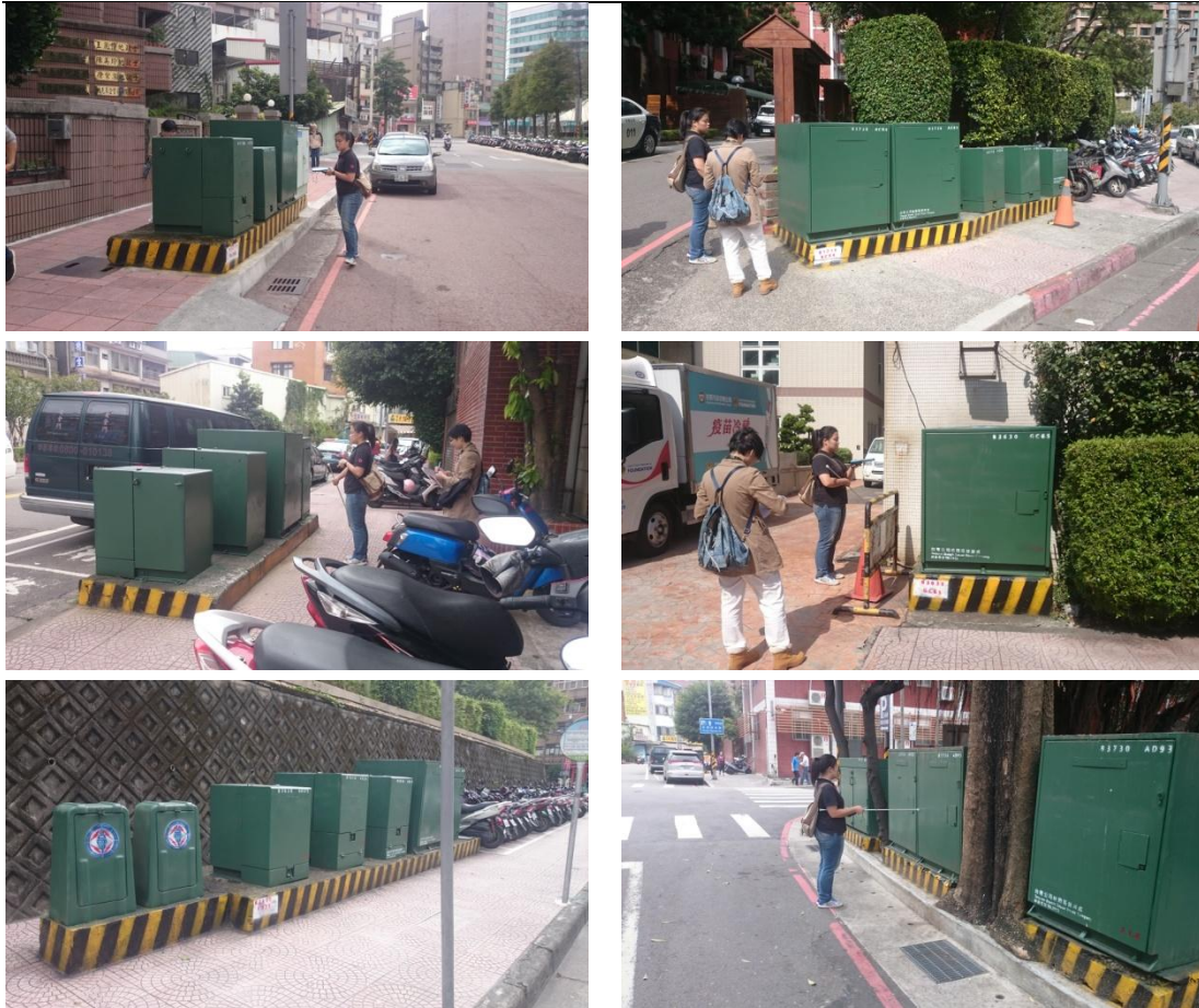
圖 2.2.4-3 案件發射源鄰近落地型變壓器
