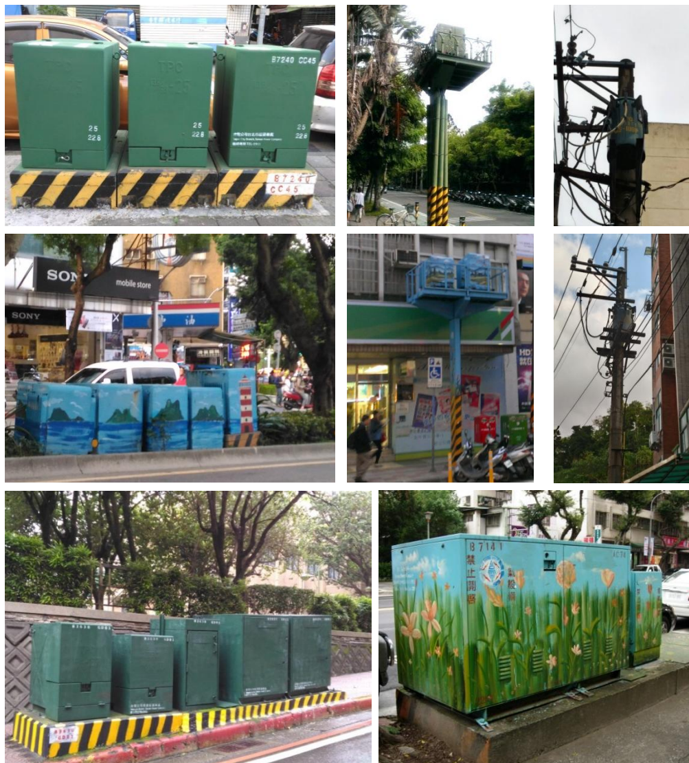
圖 2.2.3-2 台電公司輸供電系統_配電變壓器
