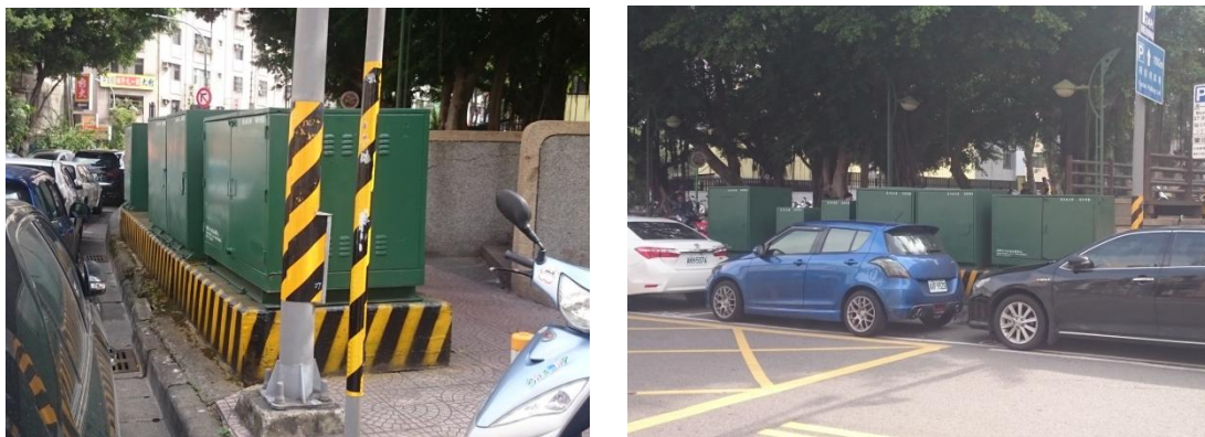
圖 2.2.4-1 案件發射源落地型變壓器
