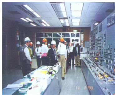
參訪林口發電廠中央控制室
