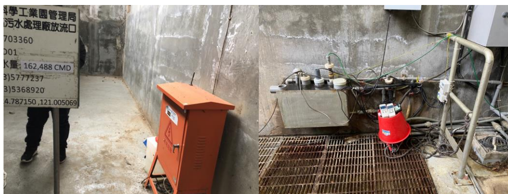
圖 4-76 新竹科學園區污水處理廠 D01 出流水採樣箱
