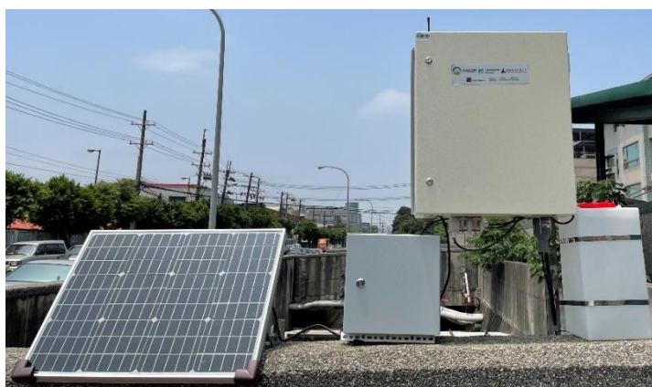
圖 3-44 鉛酸蓄電池搭配 50W 太陽能板實際完工照
