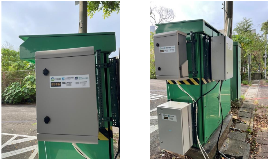
(c) 淨水廠第三驗證站-餘氯 T 3 (RC3) 圖 3-24 餘氯固定式感測機台裝設情形
